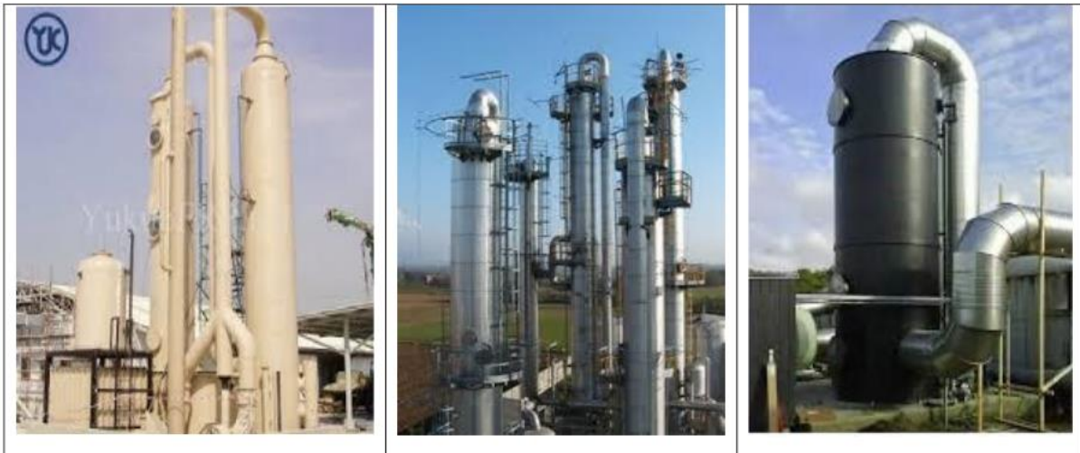
Shape 3 Actual towers
